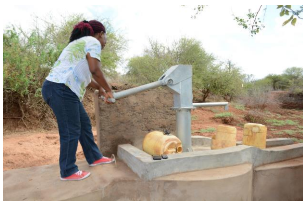
Figura 3. Fotografia del pou amb bomba d'aigua instal·lat. Font: [19]
